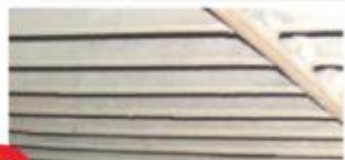
使用 FINEAMIN 处理冷却塔
