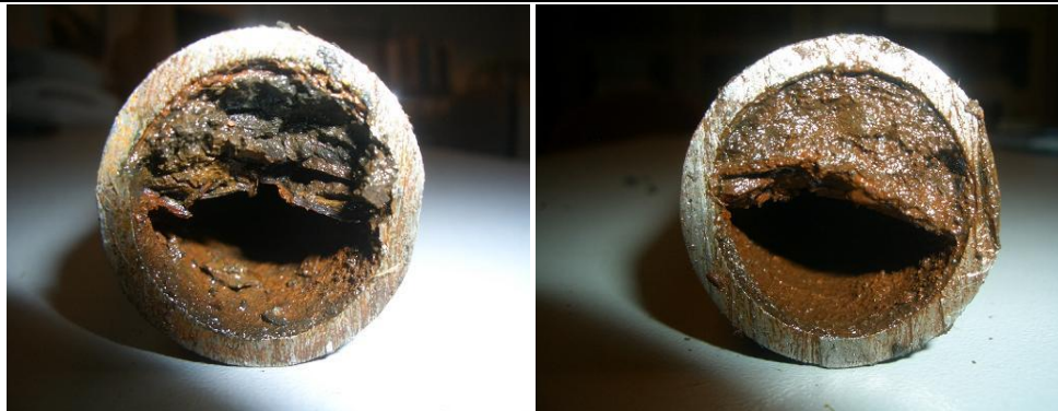
某公司未加药剂管路内的污泥沉积
