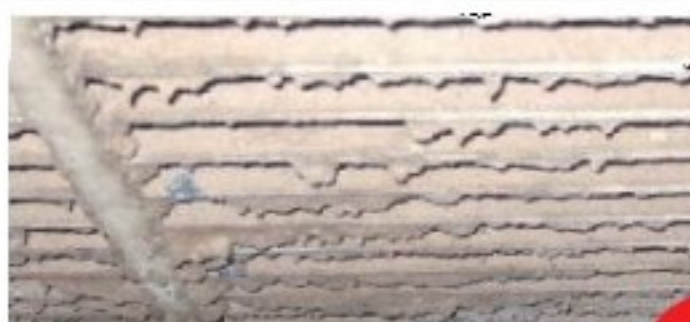
常规化学处理冷却塔
